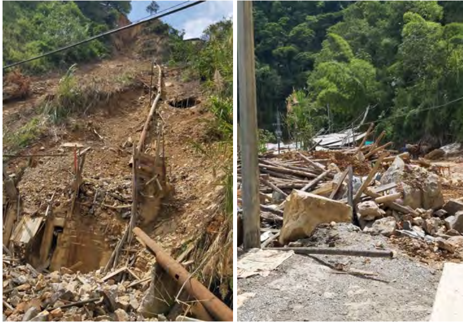
Derrumbe del taller (Mina interna).
