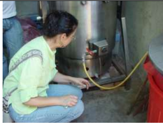
Foto: JHON AGUASACO Artesanías de Colombia Valledupar Cesar Centro de tintura Manguera de gas con riesgo de quemadura por instalación Diciembre de 2007
