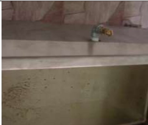
Foto: JHON AGUASACO Artesanías de Colombia Valledupar Cesar Válvula de alivio de presión La marmita no cuenta con indicador de nivel o estado del aceite térmico. Noviembre de 2007
