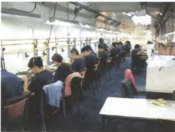
Fig. 16. Área de soldadura. Instalaciones de tubería de gas y oxígeno para little torch.
