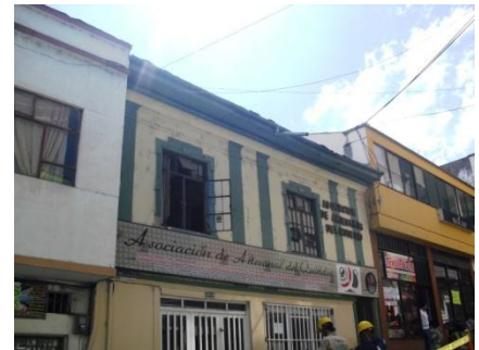
Deterioro generalizado de fachada
