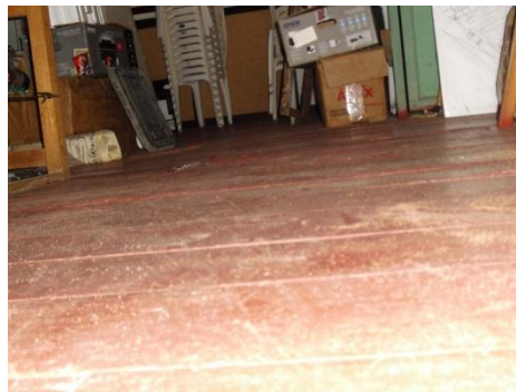
Desnivelación y pandeo
