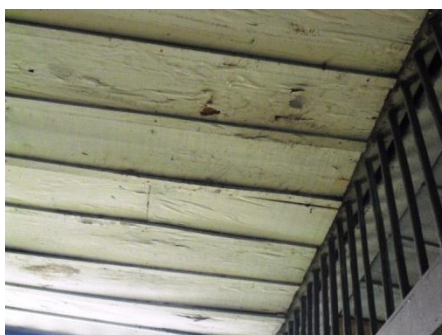
Cielos internos dañados por humedades
