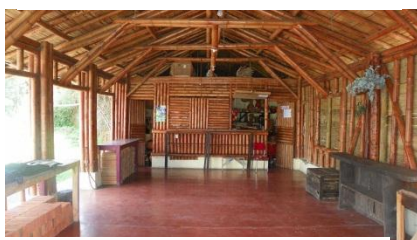
Depósito y baño cerrado con guadua y ausencia de puertas y ventanas
