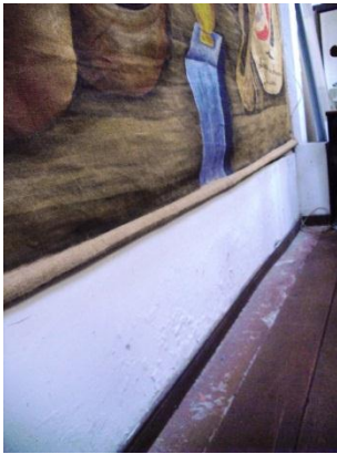
Humedad en bases de muros
