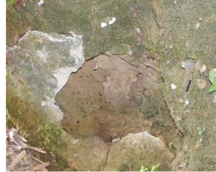
Circulación de humedad.
