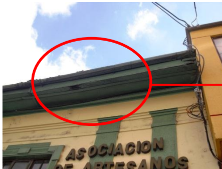
Cielo de alero podrido por humedad
