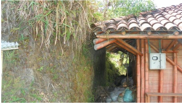
Talud de tierra vertical sin tratamiento adecuado
