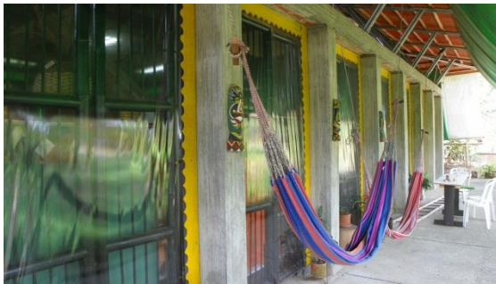
Plásticos en fachada
