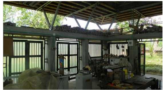
Techo demasiado dilatado
