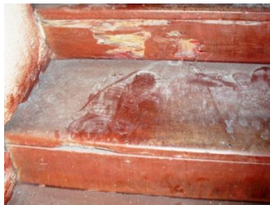
Deterioro y asentamiento
