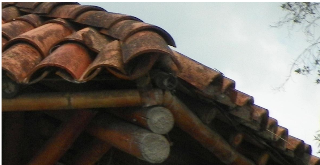
Deterioro generalizado de las guaduas de borde por salpicadura de aguas lluvias
