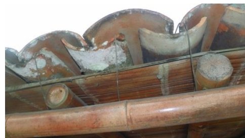
Guaduas de borde con humedad
