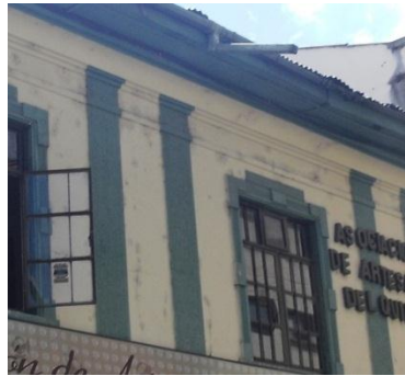
Deterioro y hongos en la fachada
