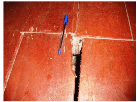
Deterioro y ataques de insectos
