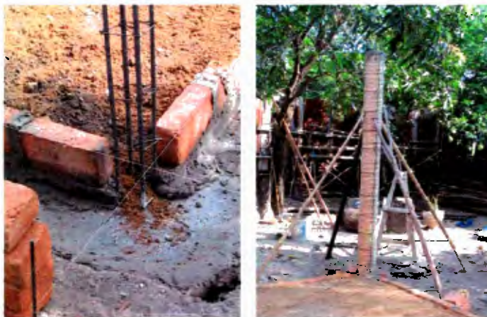
Armado de columnas de 20 cms de diámetro por 2.60 de altura en cemento y cimbra en varilla de \frac{1}{2} ".
