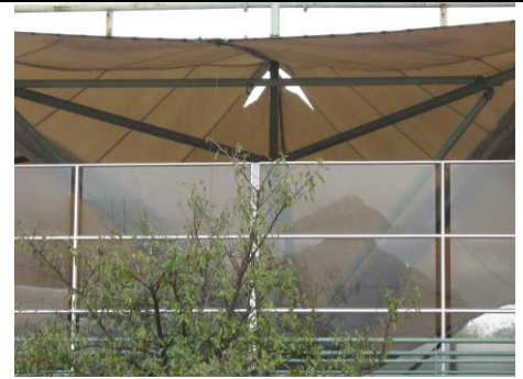
Daños Plaza No. 3
