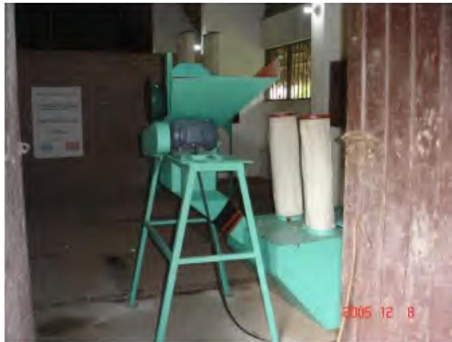
Molino con cajón receptor del producto molido, mangas en la parte superior y ensamble molino-cajón para evitar contaminación al descargue. Foto Jaime Martínez
