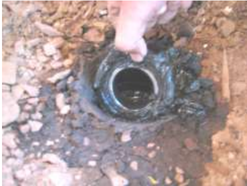
Retiro de rodamiento Inferior en mal estado Foto D.Añez
