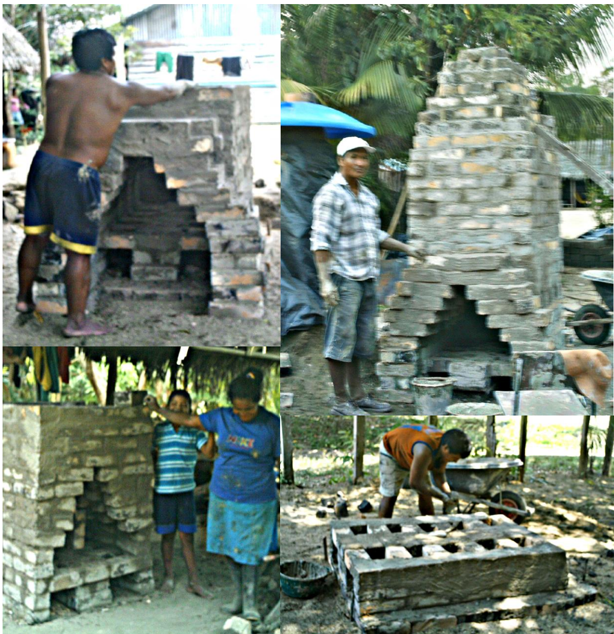
Ilustraciones fotográficas de los procesos de construcción de los hornos en solares de viviendas familiares
